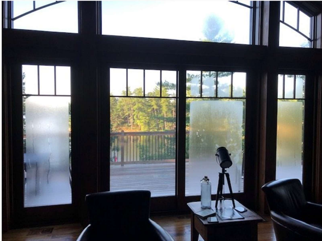
Image 2. Photo montrant le phénomène de condensation à l'extérieur des unités scellées.
